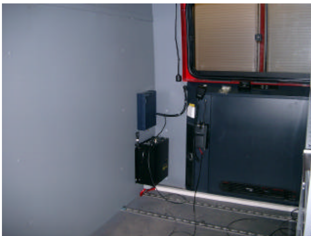
Abb. 11: Faxmodul für das GSM-Netz an der neu eingebauten Trennwand zwischen MR und GR. Daneben befindet sich der 230 V-Wandler für das Faxgerät (= Drucker und Scanner).
